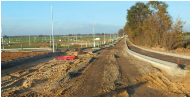
Die Erweiterung des Oerather Mühlenfeldes wird erschlossen – dabei werden auch Lösungen geschaffen, wie mit Starkregen umgegangen wird.
