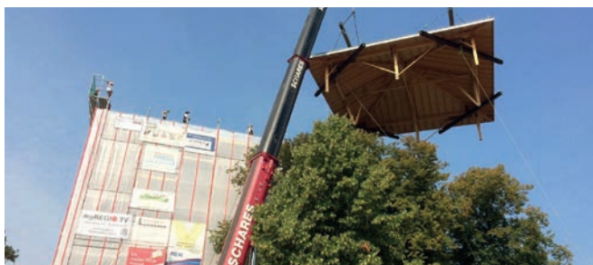
2016 wurde der Burg ein Dach aufgesetzt, um sie vor eindringendem Wasser zu schützen.
