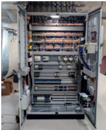
Im Schaltschrank der Gebäude-technik im Quartierszentrum Oerather Mühlenfeld laufen verschiedene Datenpunkte zusammen.
