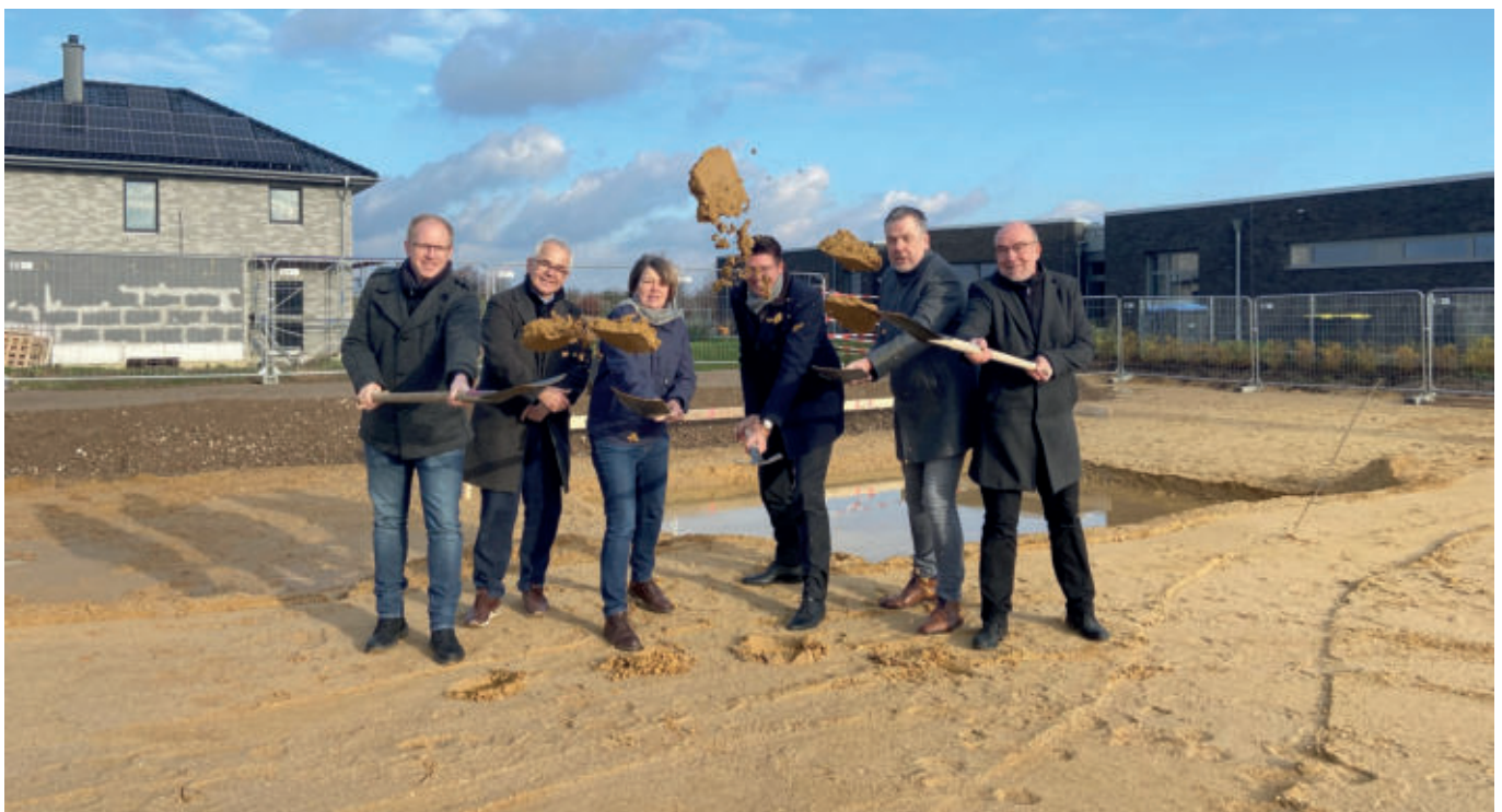
Geförderter Wohnungsbau: Im Dezember startete mit dem symbolischen Spatenstich das erste Wohnbauprojekt der GEE.
