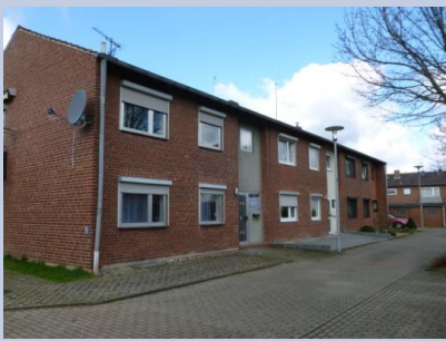
Sanierungsbedürftige RH der Bergmannssiedlung
